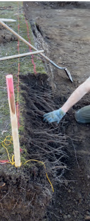
Abb. 4 und 5: Für einen Wurzelvorhang müssen alle Wurzeln abgeschnitten werden, daher handelt es sich nur um eine Schadensbegrenzung, nicht um Baumschutz.
